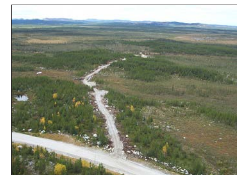
Construction de la route d'accès à la portion amont de la rivière Lemare
