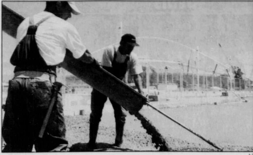
Les travaux avancent à grands pas au stade olympique d'Athènes. Pendant que des ouvriers travaillent à l'avant, derrière, on a finalement réussi à installer le toit de l'édifice principal.
