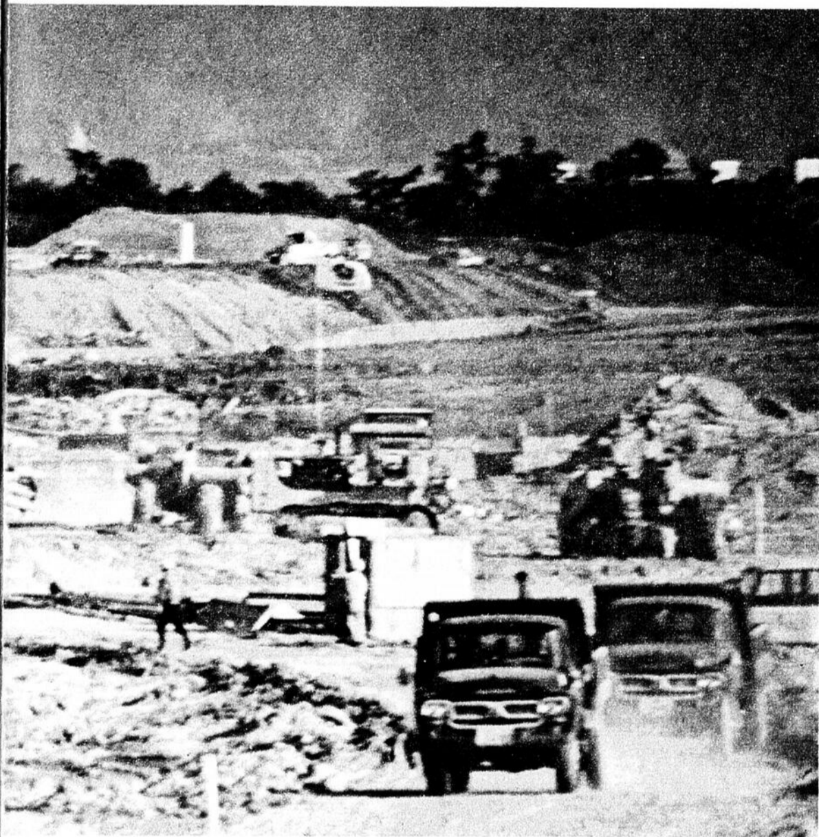
A quelques milles du centre d'Osaka, les travaux de terrassement sont déjà en voie d'achèvement sur la colline de Senri, emplacement de l'Expo 70. En mortaise, le plan directeur.
