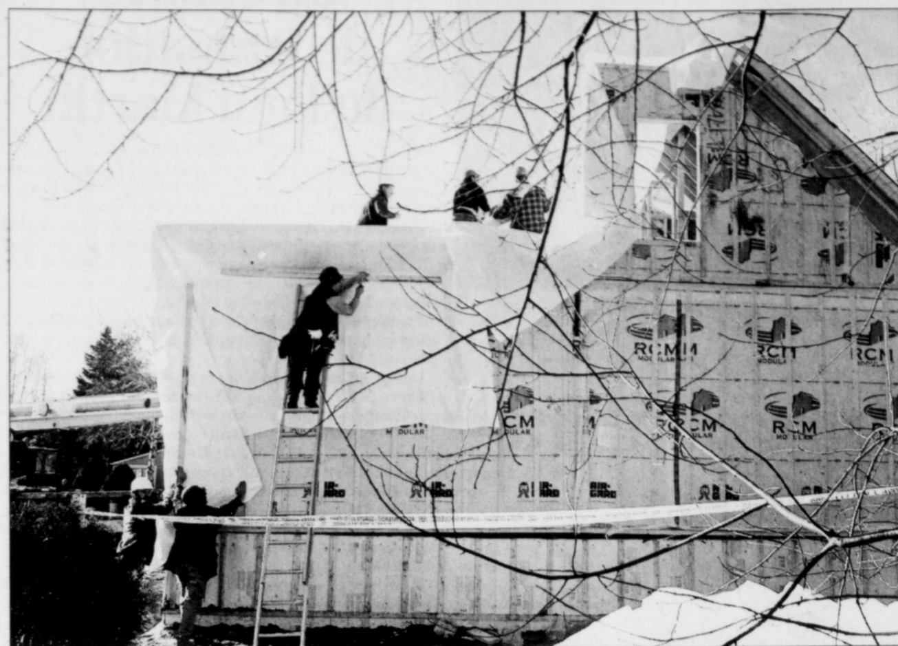
Pendant que les inspecteurs de la CSST examinaient encore les lieux, les employés de RCM Modulaire s'affairaient à poser des bâches de polythène pour fermer le trou béant laissé par l'effondrement vendredi du toit de cette maison de Saint-Ferréol. L'accident a fait deux morts et trois blessés.
