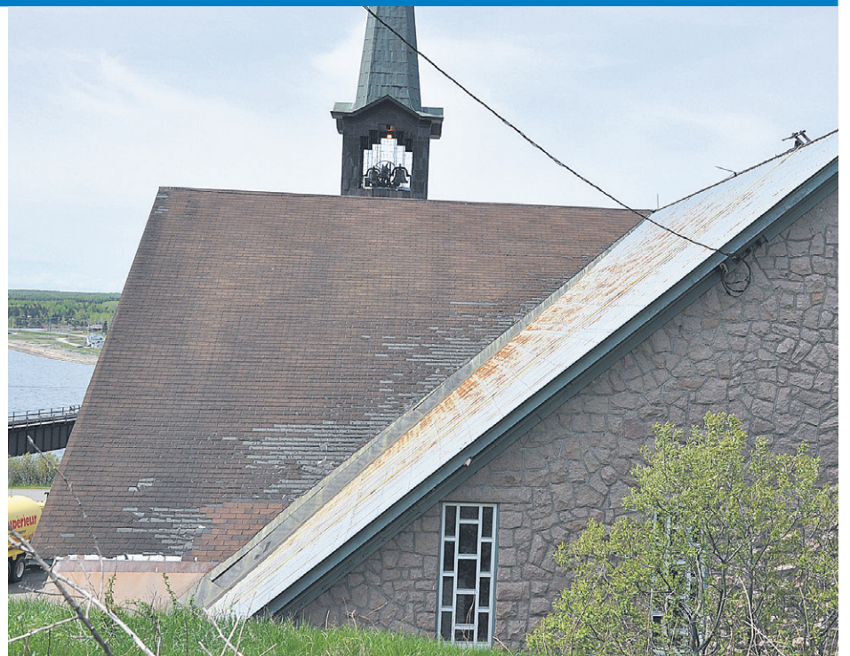
Un Comité de financement est en place à Port-Daniel-Gascons pour la réfection du toit de l'église. (Photo TC Media - Alain Lavoie)
