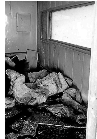
Les dégâts sont importants à l'intérieur de la cabane. — PHOTO: VILLE DE LOUISEVILLE
