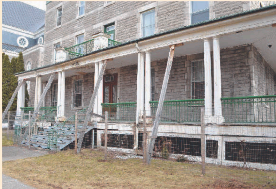
La galerie avant de la Maison communautaire est en piètre état et son accès a dû être condamné. (Photo: L'Avenir & Des Rivières – Claude Hébert)
