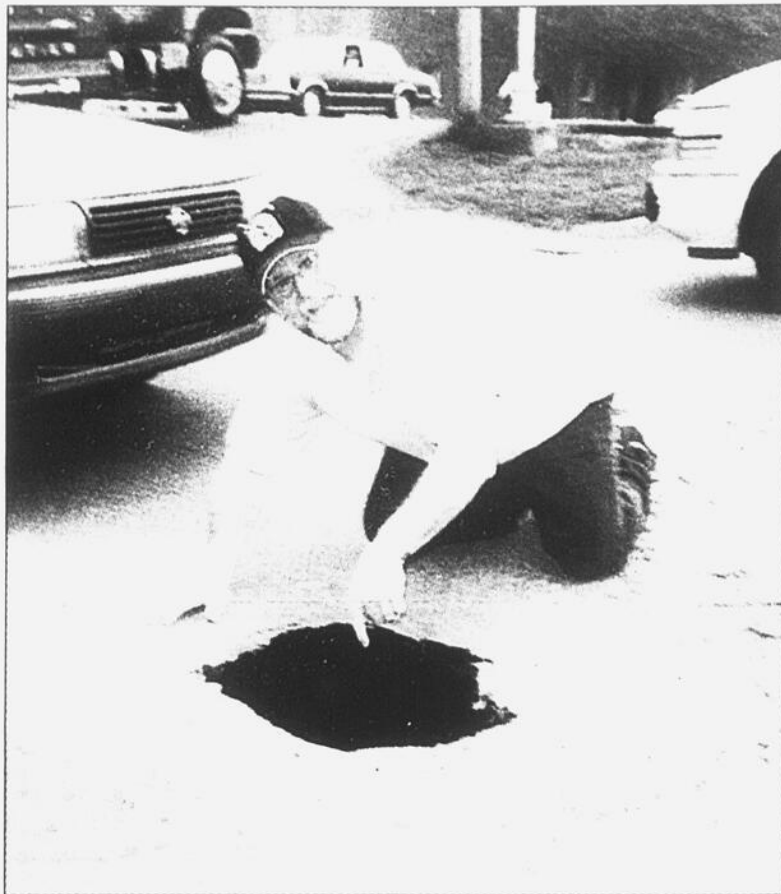
La voiture de Jacques Bolduc a provoqué un affaissement sur la rue Foch.
