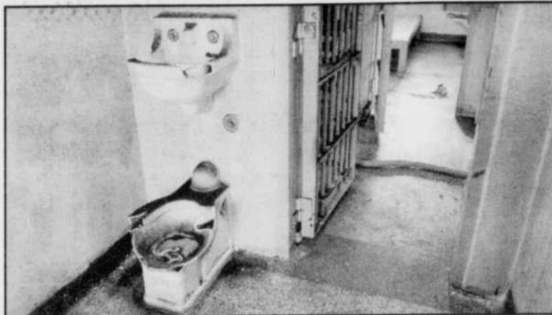
Le feu a causé bien des dommages au Centre de détention de Hull.
