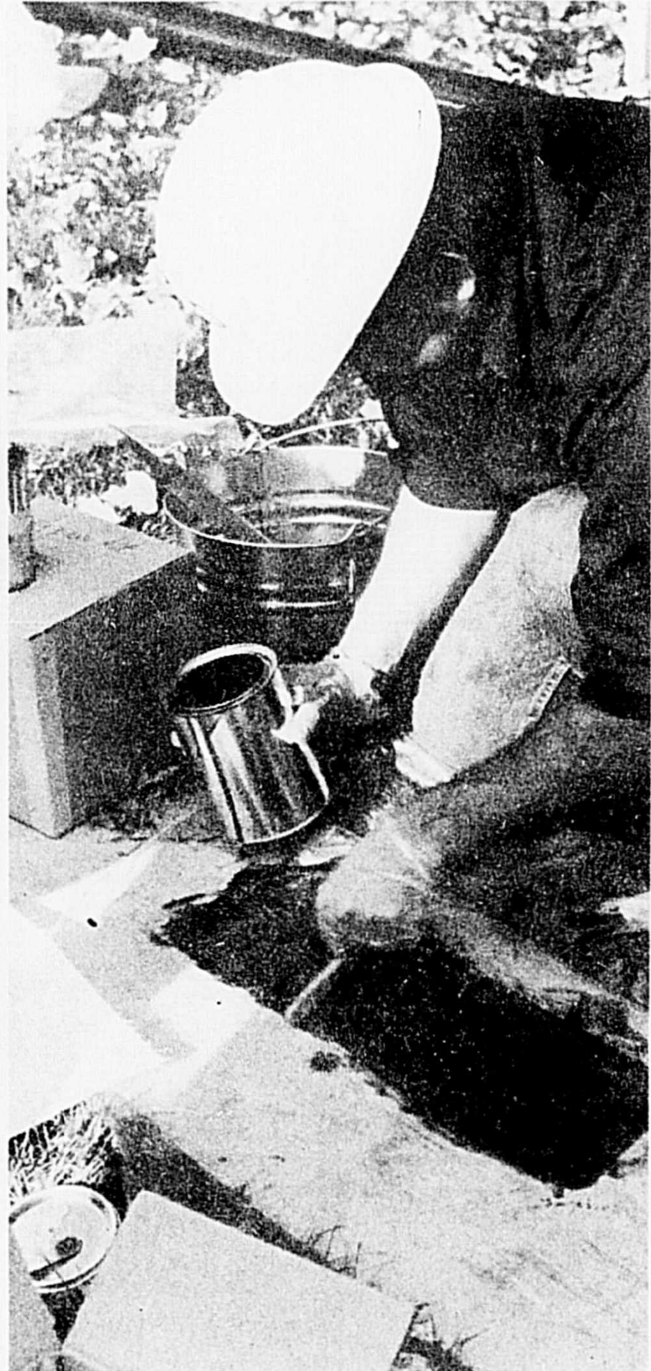
Un ouvrier prépare "le pansement" fait de tissu de fibre de verre, de résine et de produit durcissant, qui servira à assembler les conduits. Cette action sera reprise une deuxième fois après une phase de chauffage et une autre de sablage.
