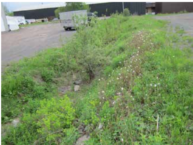
Remblai d'origine douteuse
