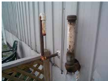
Tuyau de remplissage indiquant la présence d'un réservoir
