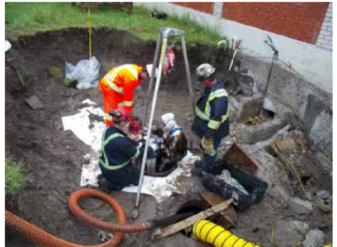
Réservoir enfoui non connu
