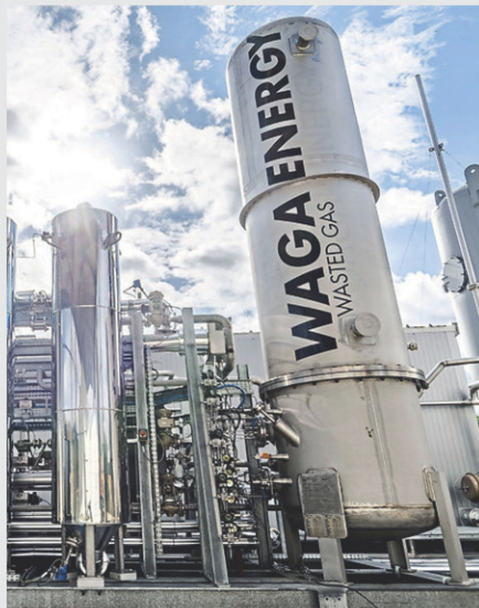
L'usine de Waga Energy au Québec est située à Saint-Étienne-Des-Grès.
