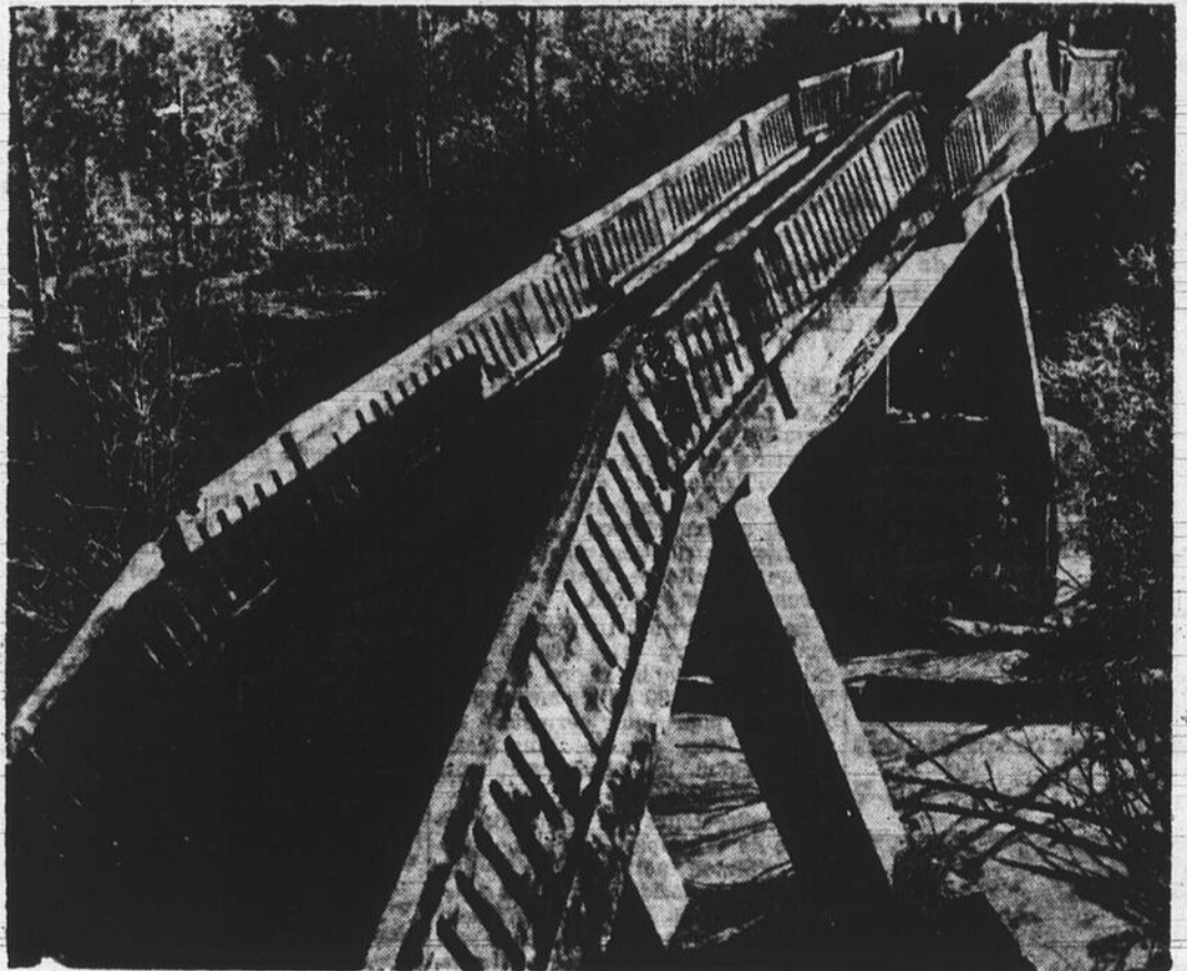
RIEN N'A RESISTE A L'OURAGAN — La crue des eaux provoquée en Ontario par l'ouragan Hazel a été telle que même des ponts en béton armé n'ont pu tenir le coup. On en voit un exemple par un des ponts surplombant la rivière Don, au nord de Toronto, dont on aperçoit la position précaire. Une quarantaine de ponts ont subi un sort identique en quelques heures dans la région de Toronto.
