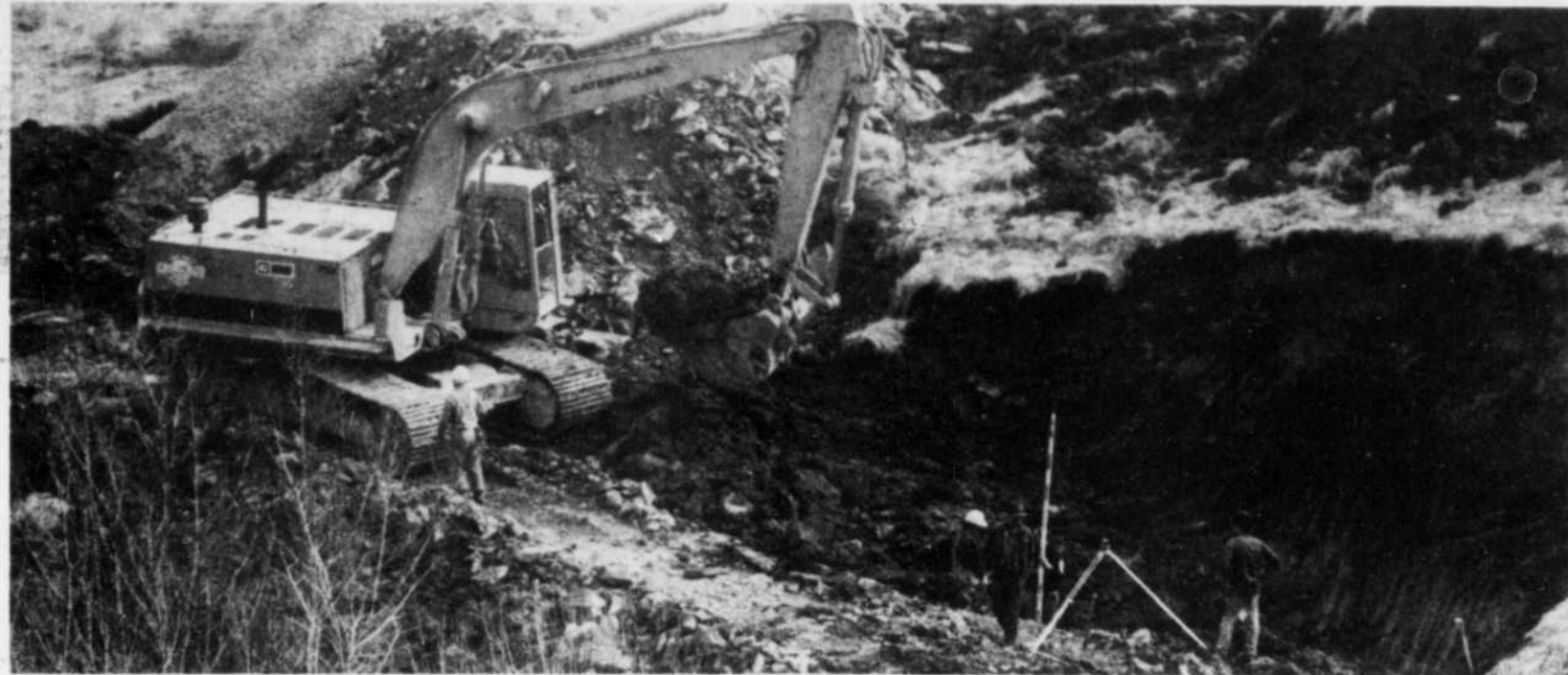
A la Division des eaux de la ville de Sherbrooke, on a fait diligence pour corriger un bris majeur, une conduite d'eau de 24 pouces de diamètre ayant cédé dans un glissement de terrain.
