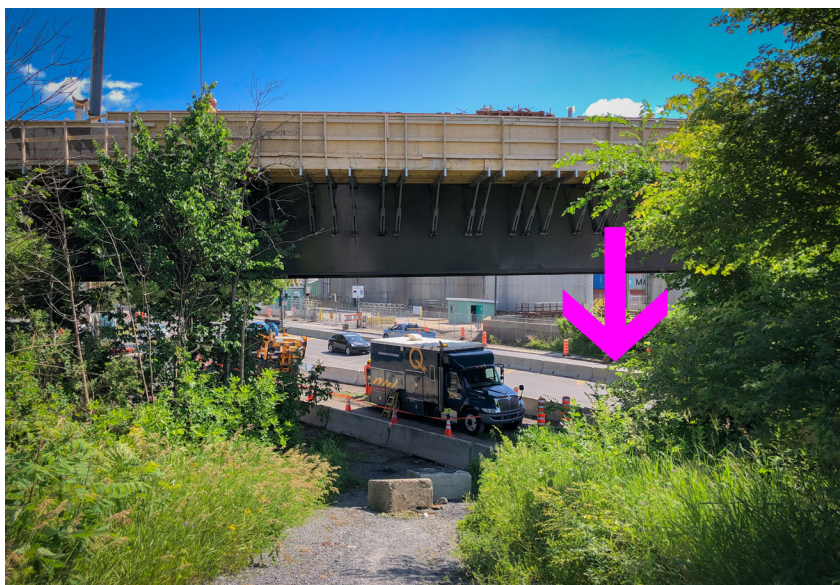
Rue Notre-Dame Est , photographe regardant vers le sud, en haut du talus de la friche ferroviaire de Viauville. Devant : en construction, le viaduc du Port de Montréal, qui sera exclusif aux camions ! Brrrrrrraaaaaa ! La flèche indique l'emplacement probable des sépultures de 1794, à possiblement 16 pieds de profond. 📷 Photo de l'auteur, lors d'une promenade de repérage en juin 2022.
