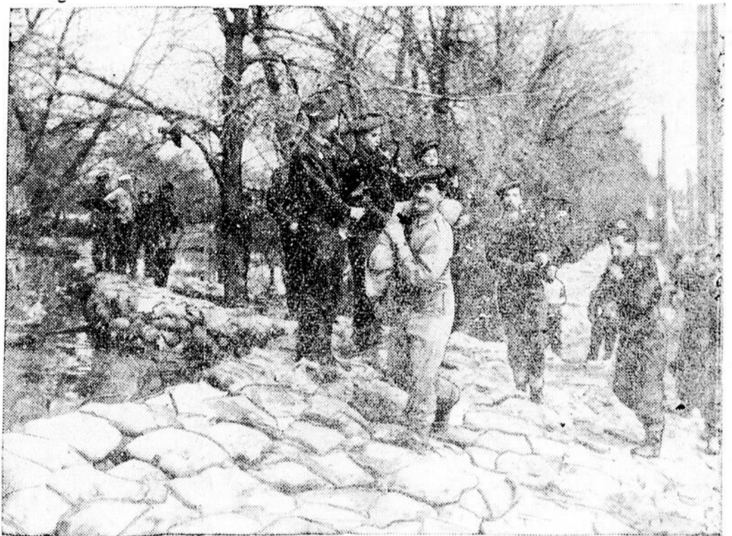
Des digues de sacs de sable installées dans la partie basse de Winnipeg, sont construites par le régiment de la reine, QUEENS OWN CAMERON HIGHLANDERS, dans un effort pour parer à l'inondation de la rivière Rouge, couvrant une partie de la ville.
