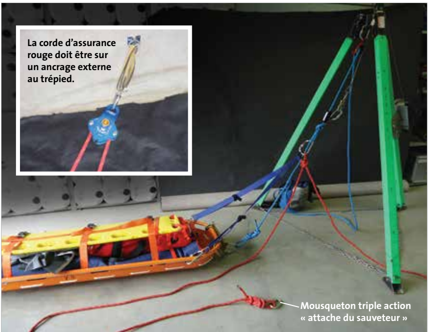
Trépied installé en hauteur avec treuil
