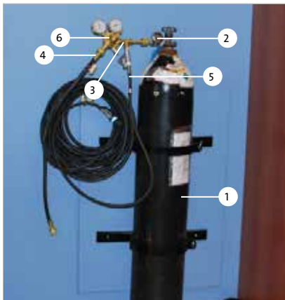
Système de recharge et d'alimentation
