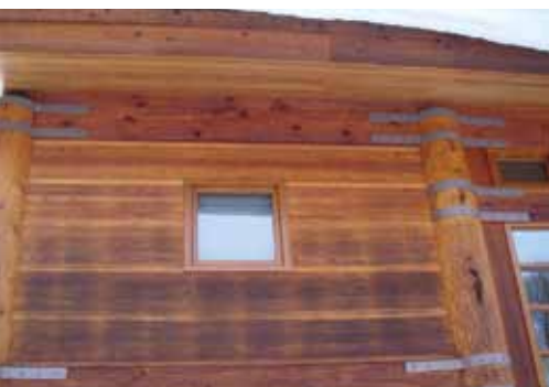
Taches en service observées sur les bardages de cèdre de cette maison où l'absence de coloration suit le motif des colombages et est également remarquable sous les porte-à-faux.
