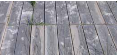
Altération de planches de terrasse due aux intempéries.
