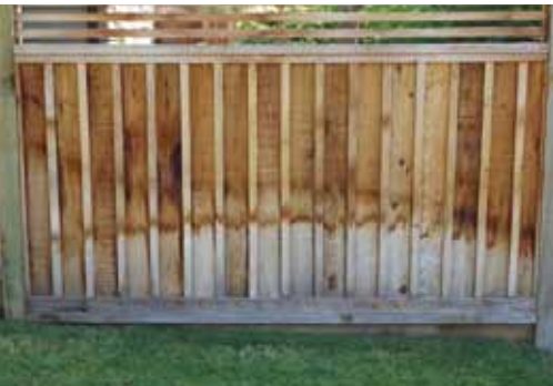
Tache d'eau sur une barrière de cèdre rouge de l'Ouest causée par le système de gicleur automatique, occasionnant le mouvement et le lessivage des produits d'extraction solubles. Photo reproduite avec la permission de Les Jozsa.
