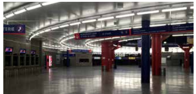
Nouvel éclairage aux DEL dans la Rotonde.
