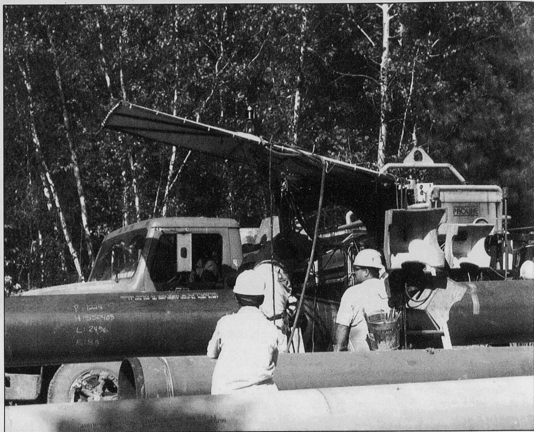
La machinerie chargée de la manutention des tuyaux est conçue exclusivement pour cette fonction. Un système de contre-poids empêche les grues de verser sur le côté à cause de la masse importante des tuyaux.
