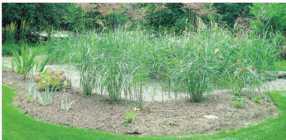
L'eau en provenance d'une fosse septique circule dans ce «milieu filtrant» où sont semées des plantes qui contribuent à l'aération d'un lac ou d'un cours d'eau. — PHOTO FOURNIE PAR HG
