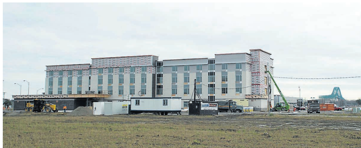
Le chantier du futur hôtel Holiday Inn va bon train, mais d'autres projets pourraient être retardés ou complètement annulés si le colisée n'est pas bâti au District 55. — PHOTO SYLVAIN MAYER
