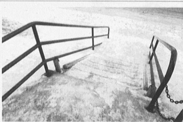
ATTENTION À LA MARCHÉ... - Le photographe est revenu la semaine dernière de l'école Immaculée-Conception de Saguenay avec ce cliché d'un escalier dont le moins qu'on puisse dire c'est qu'il pourrait servir de glissade... Attention à la marche? Pas d'autre commentaire, ça parle tout seul... (Photo Rocket Lavoie)
