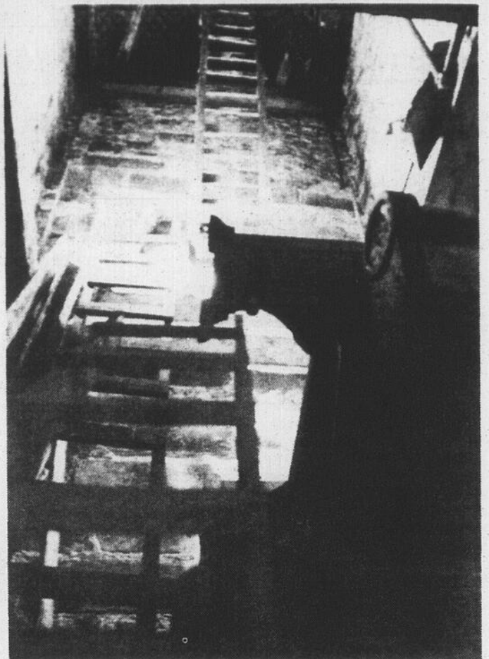
En suivant ces échelles, on aboutit dans un des clochetons. Peu recommandé à ceux qui sont sujets au vertige...
