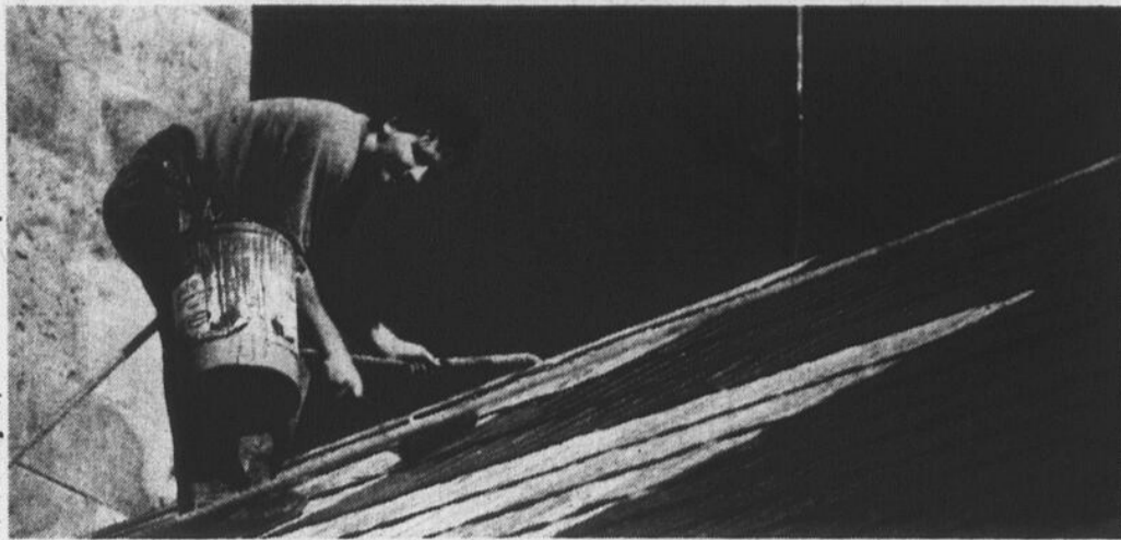
Que ceux qui ont vu la couleur du toit de la Cathédrale passer de l'argent au rouge se rassurent: la peinture rouge n'est qu'une
