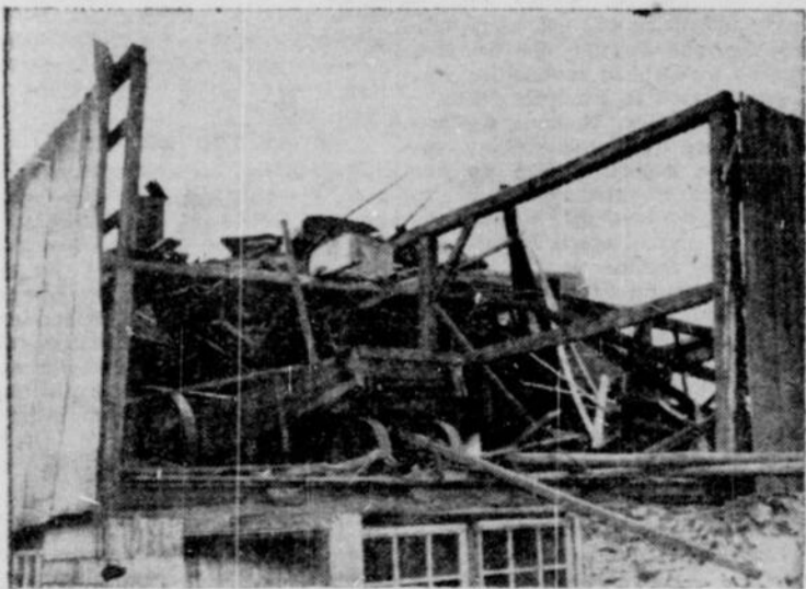
Cette grange se trouvait sur le passage du vent, à Rock-Forest. Comme le vent avait les proportions d'un cyclone, il ne reste, ci-dessus, pas grand-chose de la grange. (Photo «ACE», par René-S. Lefebvre)
