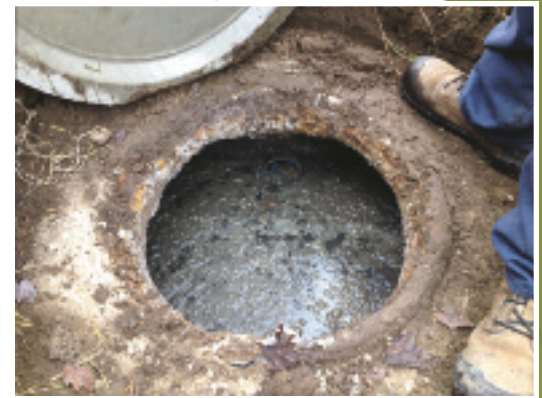
Fosse septique : un niveau d'eau supérieur au radier de sortie est un indicateur du dysfonctionnement du dispositif de traitement des eaux usées.
