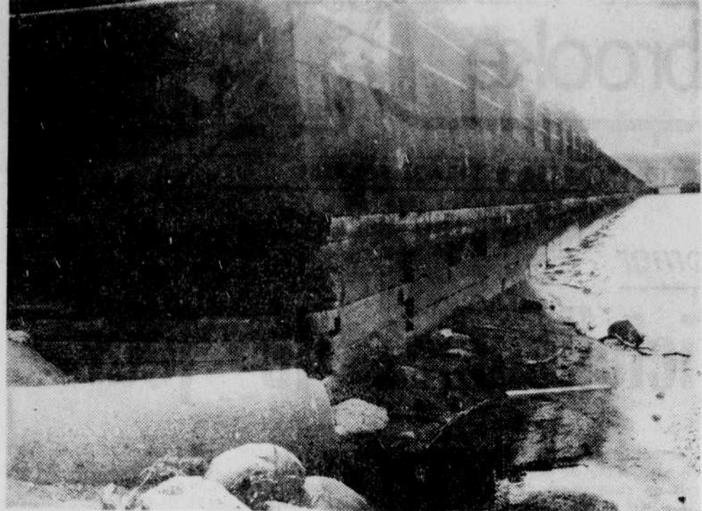
L'absence d'eau a des conséquences un peu partout sur le pourtour du lac Mégantic et les poutres qui soutiennent la promenade du parc des Vétérans se désintègrent à l'air libre.
