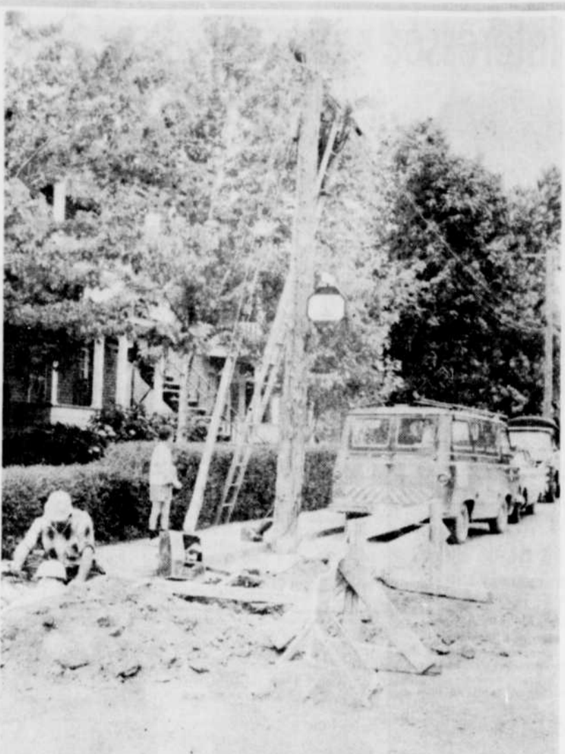
CABLE BRISE. — Les employés de la compagnie de téléphone Bell se sont affairés hier à rétablir le service téléphonique sur trois artères de la ville de Granby, à la suite du bris d'un câble souterrain à l'intersection des rues St-Luc et St-Louis.
