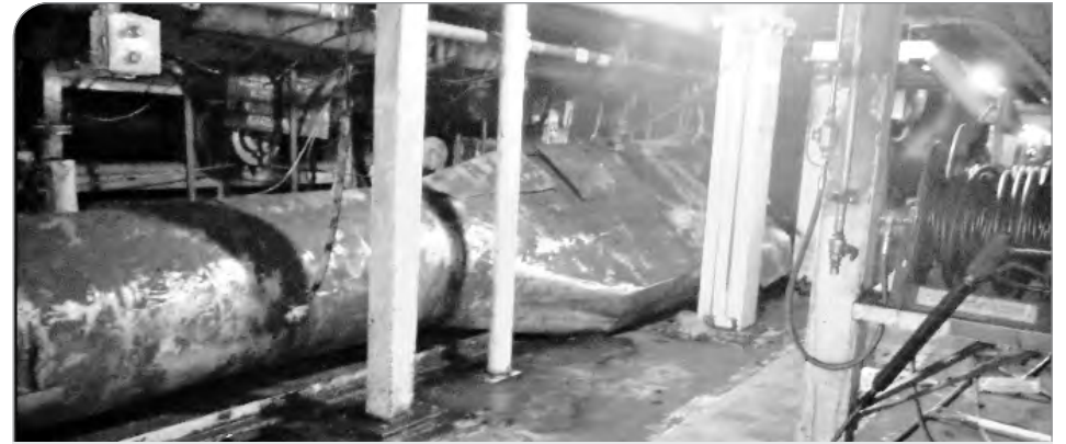
Conduit de ventilation de procédé de séchage effondré au sol. PHOTO : CNESST
