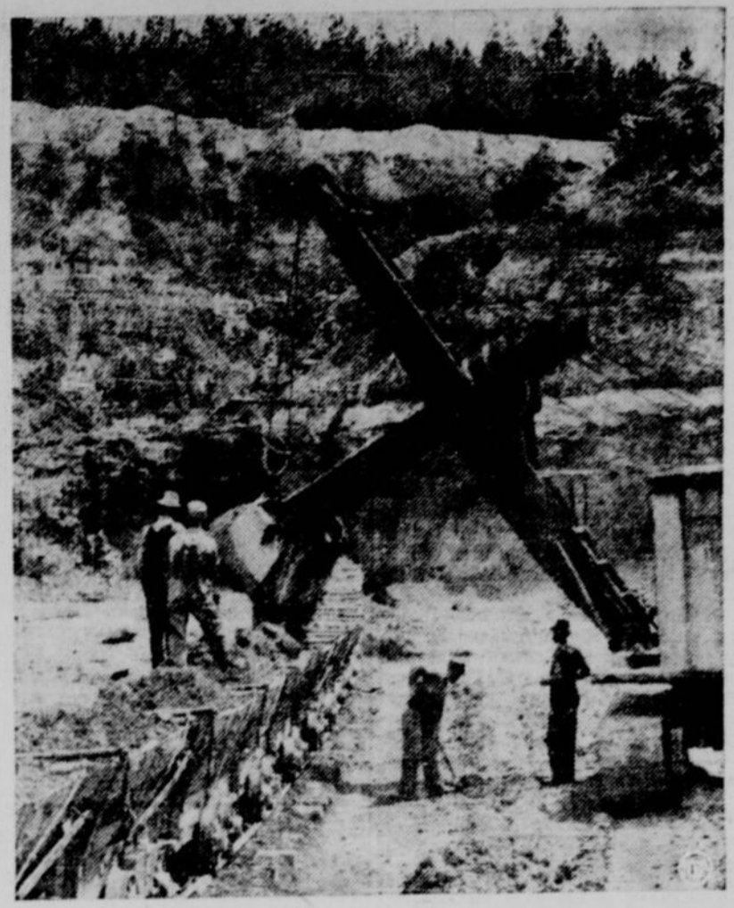
Dans cette mine ouverte à Bauxite, Ark., une pelle mécanique charge la bauxite dans des wagonnets qui se dirigent immédiatement vers l'usine. Des mines de la région nous parviennent à peu près les trois quarts de notre aluminium.
