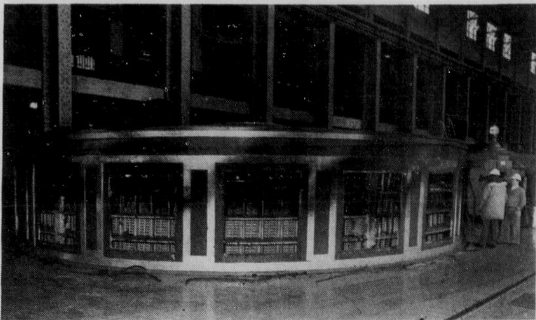
Même si le service de sécurité a réussi à maîtriser rapidement l'incendie, limitant ainsi les dommages, Hydro-Québec devra déboursier près de $1.5 millions pour remettre en marche le Groupe 1 de la Centrale Hydro électrique de Beauharnois. (Photo Le Soleil Pat McKay)
