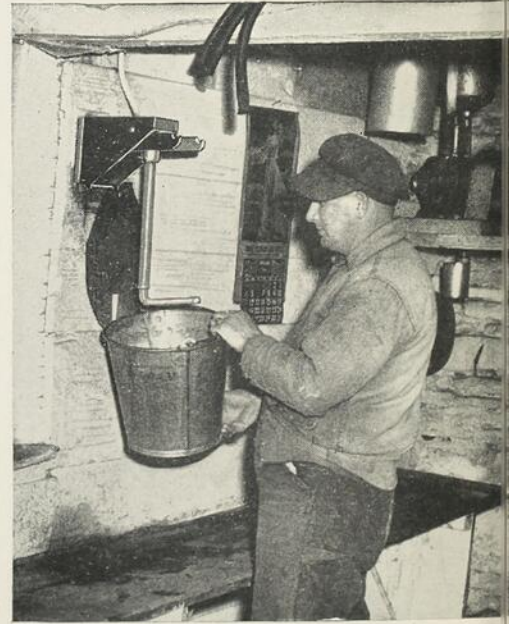
CHAUFFE-EAU À IMMERSION —placé à côté de l'évier dans l'étable laitière, il fournit rapidement l'eau chaude nécessaire pour nettoyer l'équipement là où il n'y a pas de réservoir d'eau chaude.
