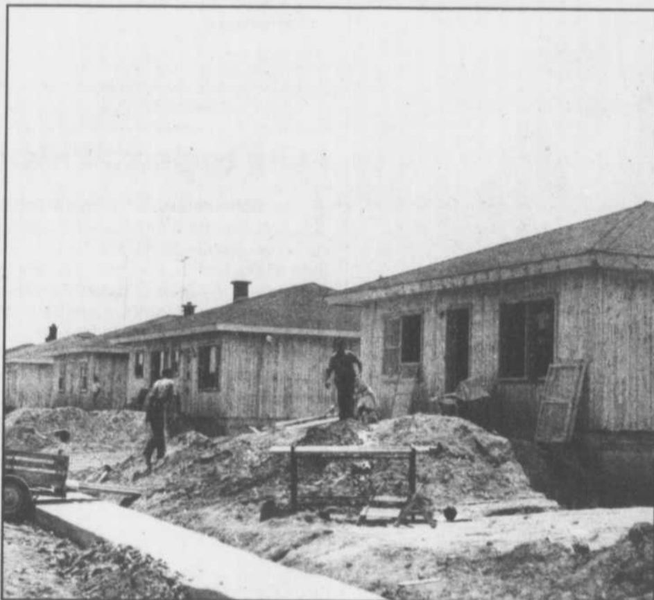
Les maisons de la rue de l'abbé Pierre en construction. Photo de la collection Aimé Despatis datée de juin 1957.
