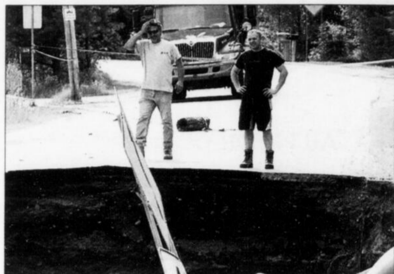
Des experts d'Hydro-Québec ont inspecté un trou dans la route 307 près de Bowman. La route a été rouverte vendredi.
