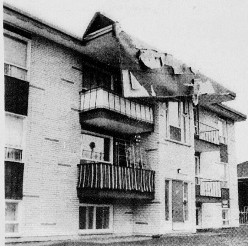
SOUFFLE - Le vent a soufflé très fort, hier, boulevard Tadoussac, à Chicoutimi secteur nord. Tellement que le toit de cet édifice situé au 1830 a été retroussé comme une vieille semelle. Heureusement, plus de peur que de mal pour les habitants.
