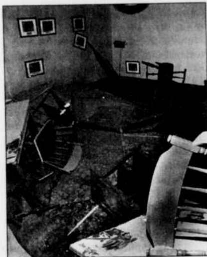
Murs, meubles et plafonds avaient littéralement été brisés et déplacés lors de l'explosion.
