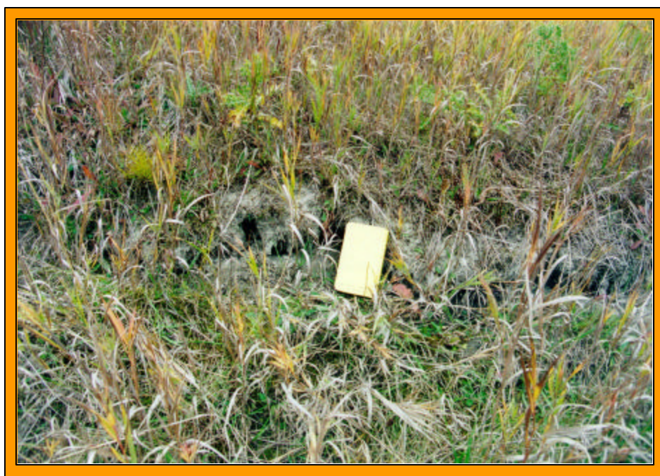
B : Fissure de chevauchement à la base du talus (près du calepin de notes).
