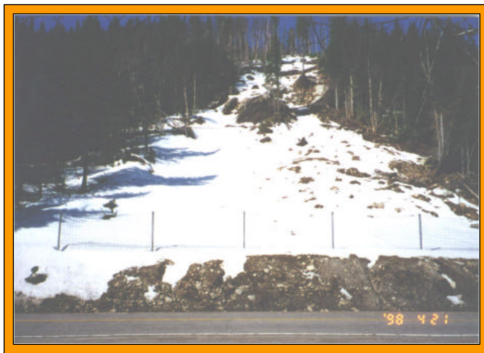
Figure 45: Clôture de captage servant à retenir les blocs rocheux éboulés; route 169, kilomètre 22, parc des Laurentides.
