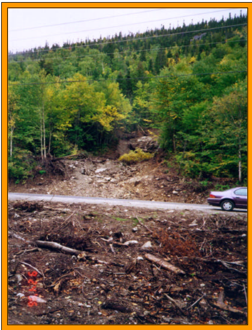
Figure 34 : Coulée de débris dont les matériaux glissés ont encombré entièrement la route 170.
