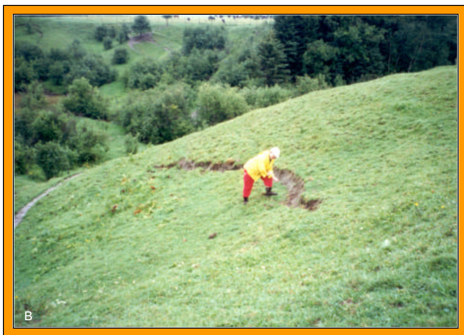
B : Talus sans érosion à la base montrant une fissure majeure avec un affaissement, délimitant une zone de stabilité marginale (rang Dorval, Larouche).
