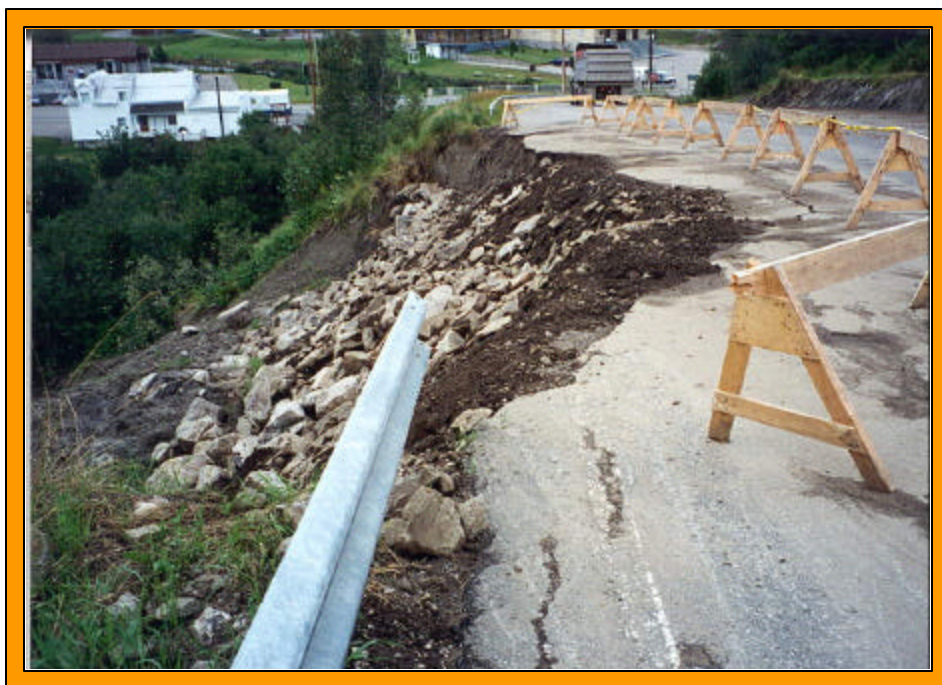
Figure 32 : Route coupée par un glissement de terrain à Rivière-Éternité.
