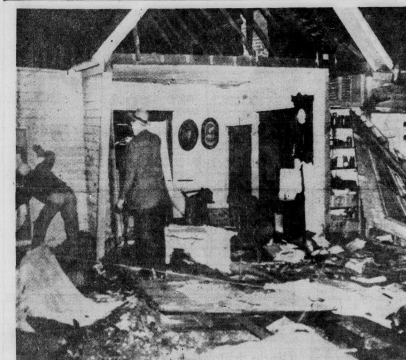
VENTS DEVASTATEURS : Les voisins vérifient une maison démolie par des vents violents, hier, à Mount Vernon, dans l'Illinois. Entre 75 et 100 maisons ont été détruites ou gravement endommagées par les tornades qui ont soufflé sur les régions du sud de l'Illinois et de l'est du Missouri.
