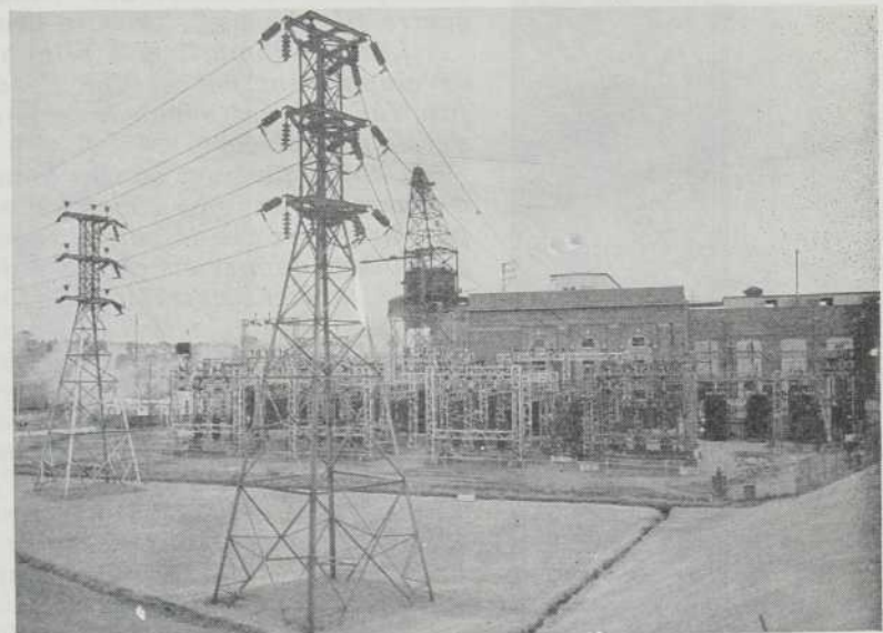
LA SOUS-STATION LASALLE, A VILLE LASALLE, EST UN EXEMPLE TYPIQUE DE SOUS-STATION EXTERIEURE.
