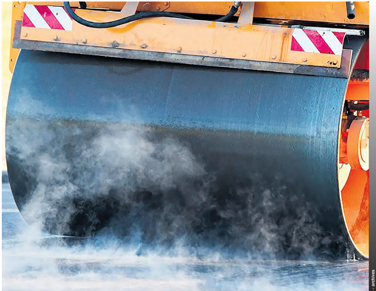
Les travaux d'asphaltage et d'aménagement de l'îlot central s'échelonnent sur deux semaines
