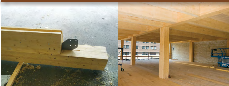
Figure 6 Attaches dissimulées pour une résistance au feu accrue
