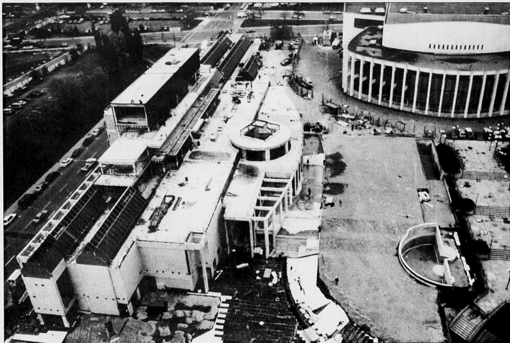
Le chantier de construction du nouvel édifice du Musée d'art contemporain de Montréal, photographié en décembre 1990.
