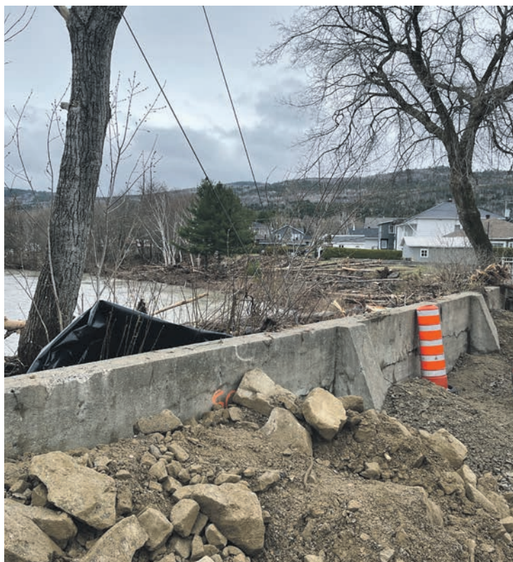
Le mur bordant la rivière du Gouffre, juste après les inondations du 1 er mai.
