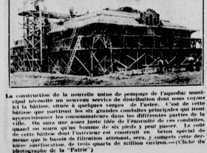
La construction de la nouvelle usine de pompage de l'aqueduc municipal nécessite un nouveau service de distribution dont nous voyons ici la bâtisse, située à quelques verges de l'usine. C'est de cette bâtisse que partiront les six grandes conduites principales qui iront approvisionner les consommateurs dans les différentes parties de la ville. On aura une assez juste idée de l'énormité de ces conduites, quand on saura qu'un homme de six pieds y peut passer. Le coût de cette bâtisse dont l'intérieur est construit en béton spécial de ciment, que le bassin de filtration attenante, sera, y compris cette dernière amélioration, de trois quarts de million environ. (Clique du photographe de la "Patrie").
