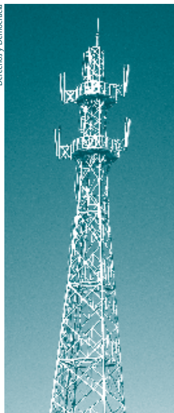
Estaciones de base (torres) permiten la utilización de la tecnología GSM-R.
