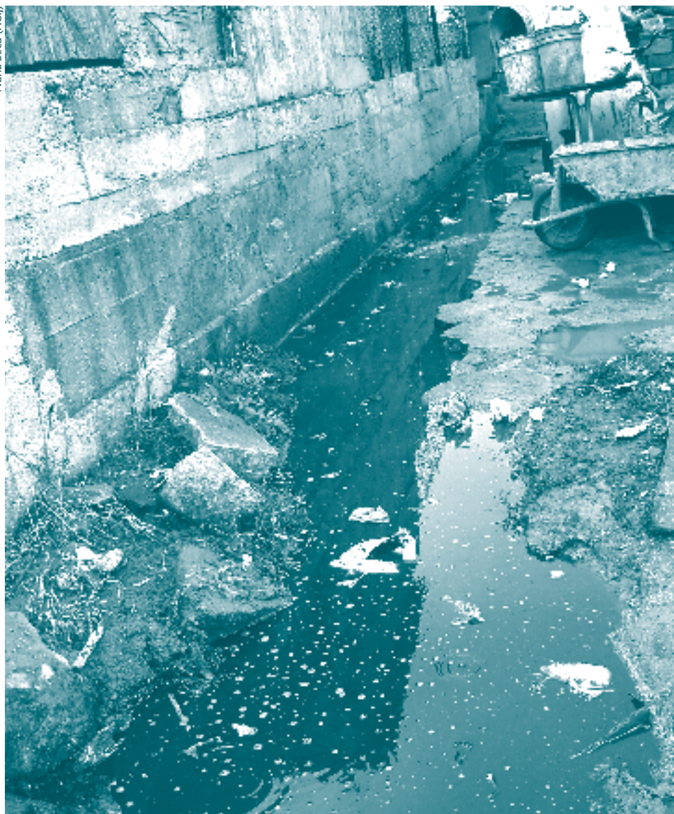
El gobierno debería vaciar todos los días los pozos ciegos improvisados, pero no lo hace. Por lo tanto, los pozos se rebalsan.
