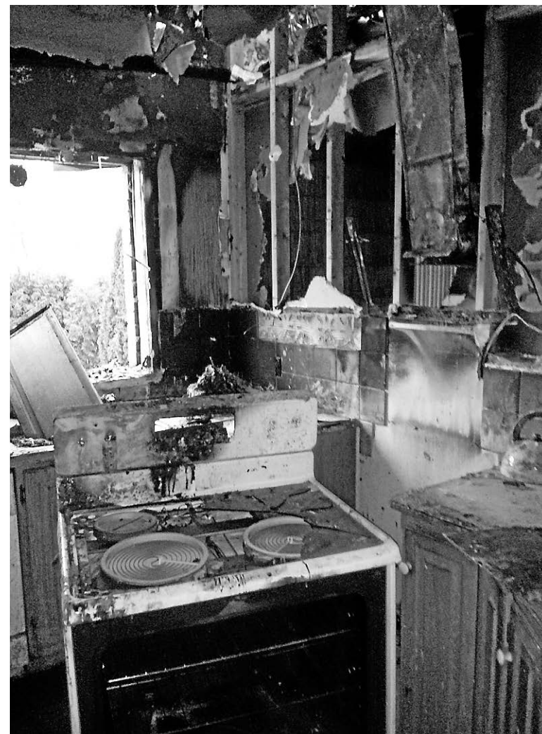
L'état de la maison après l'incendie de février 2014.
