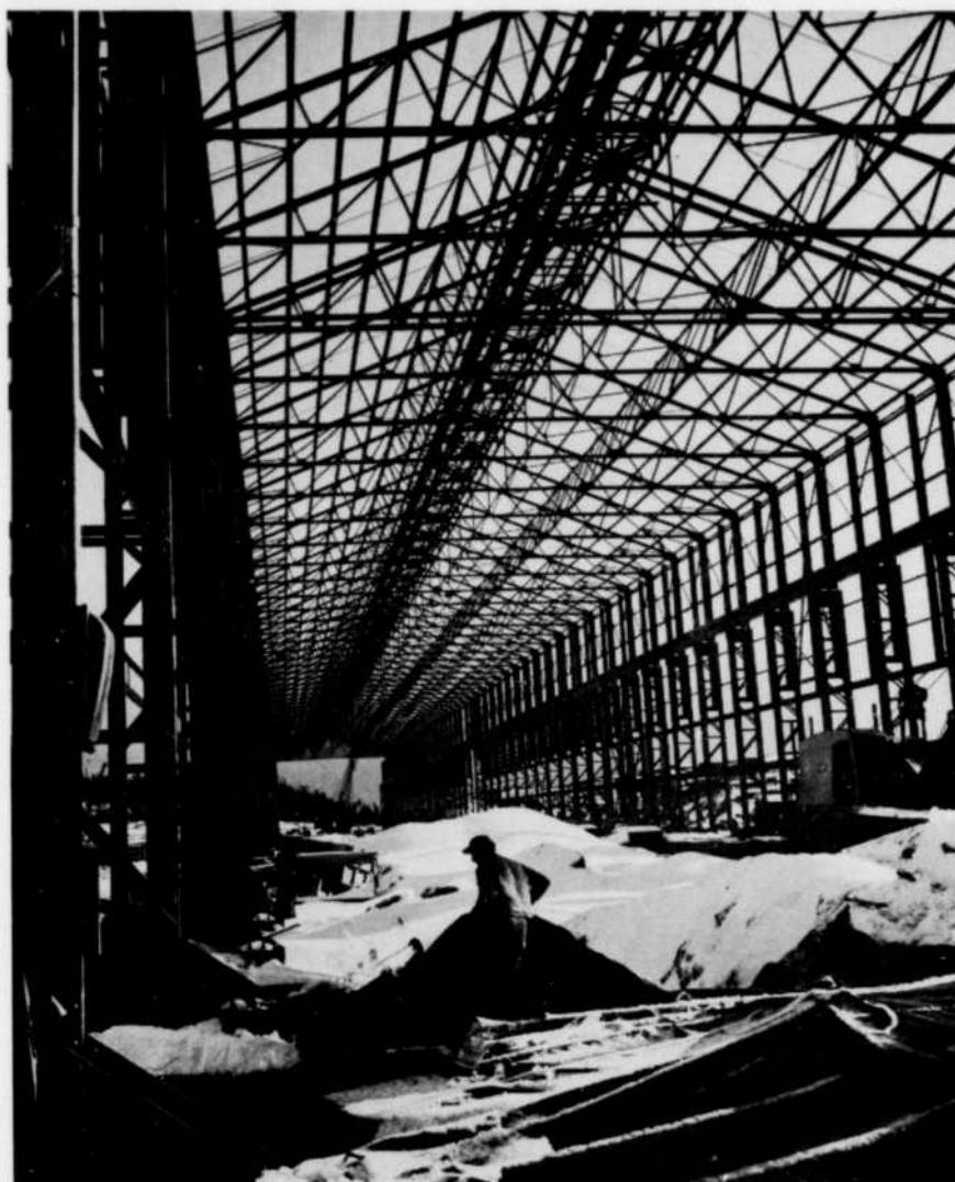
Les salles de cuves de la Canadian British Aluminium, longues de 1,700 pieds, ont demandé des milliers de tonnes d'acier. L'aluminerie comprend deux de ces salles par 45,000 tonnes de capacité annuelle. Les cuves fonctionnent à 100,000 ampères.
