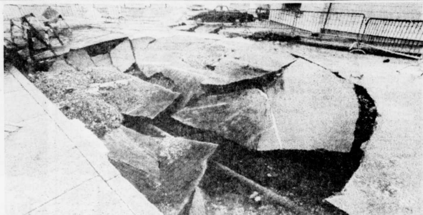
Une partie de la rue Aqueduc à Québec arborait cette image à la suite de la rupture d'une conduite d'eau survenue dimanche.
