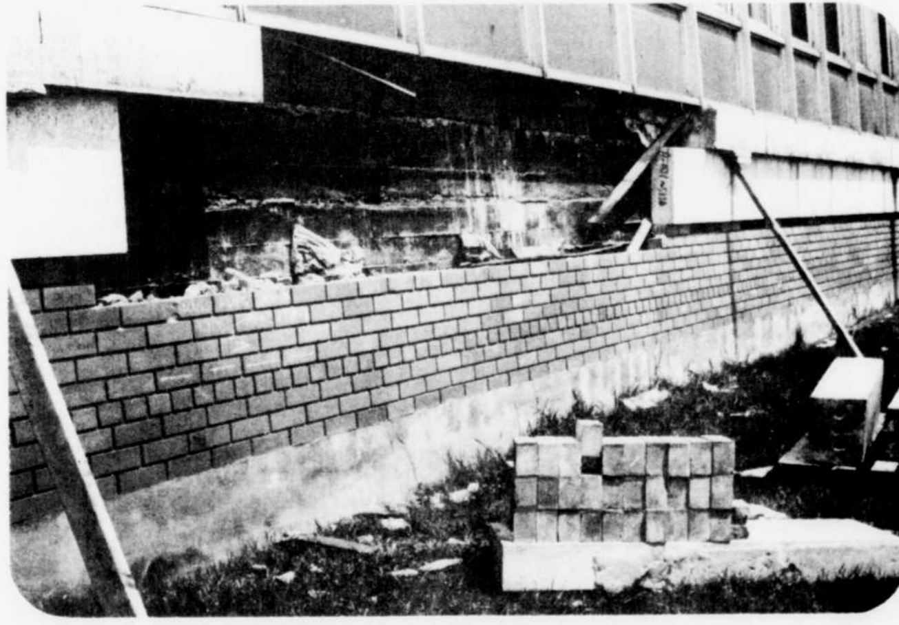
On se perd en conjectures sur la cause de la détérioration d'un des murs de l'école St-François dans le quartier Ouest. (Photo La Tribune, Doug Gerrish)
