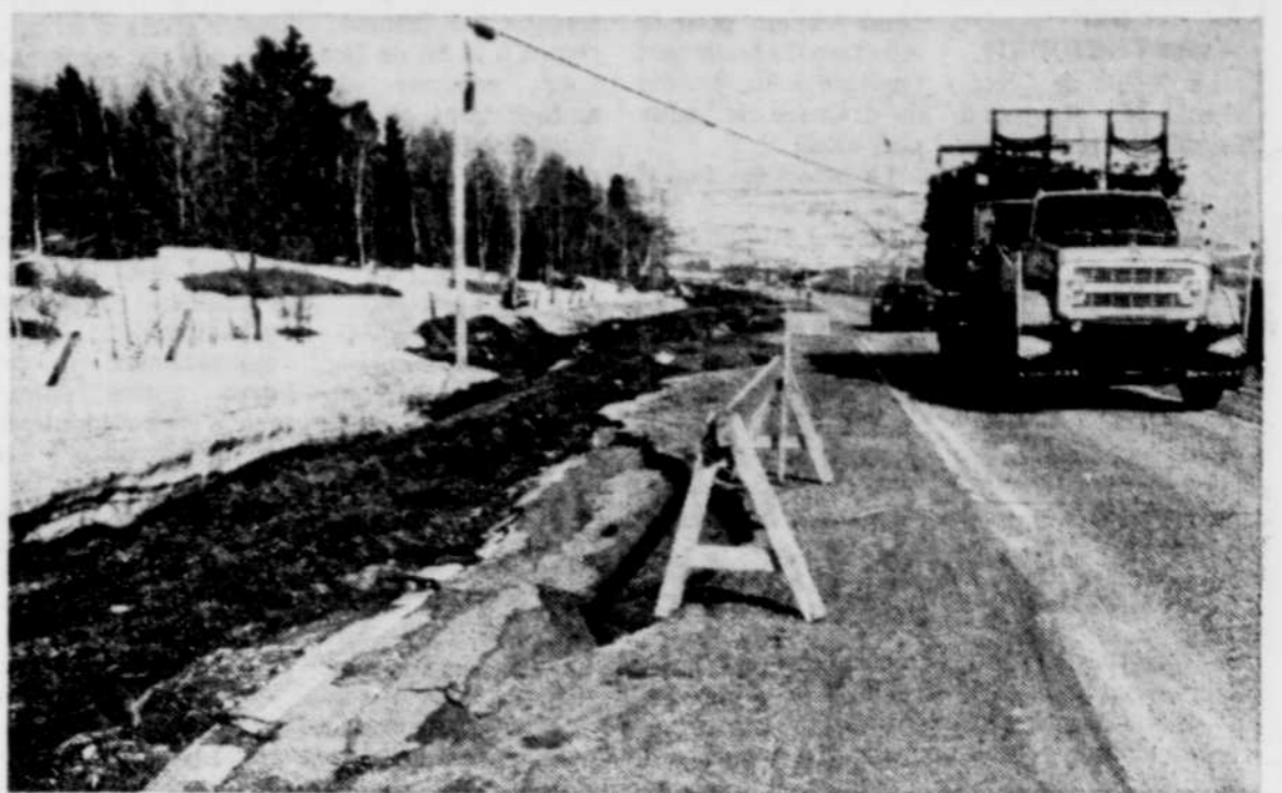
En mars dernier, les fortes pluies ont endommagé plusieurs routes, dans Charlevoix.
